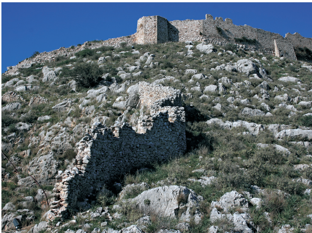
Εικόνα 2B: τμήμα του ανατολικού περιβόλου μετά την κατάρρευση (2008)
